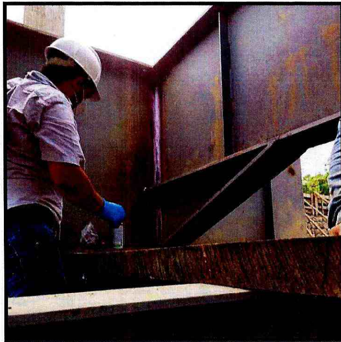
Fotografía 4. Ensayo de tintas penetrantes
