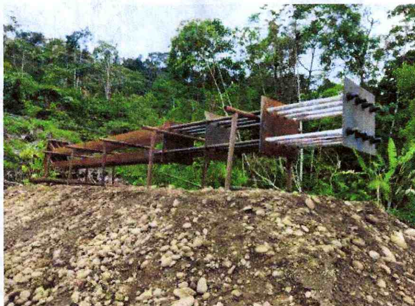
Fotografía 3. Piezas mecánicas de anclaje – margen izquierdo
