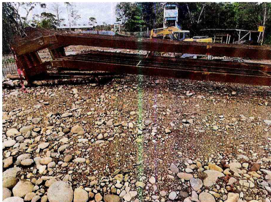
Fotografía 2. Piezas mecánicas de anclaje – margen izquierdo
