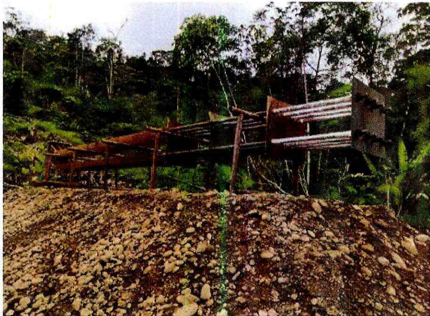
Fotografía 1. Piezas mecánicas de anclaje – margen izquierdo
