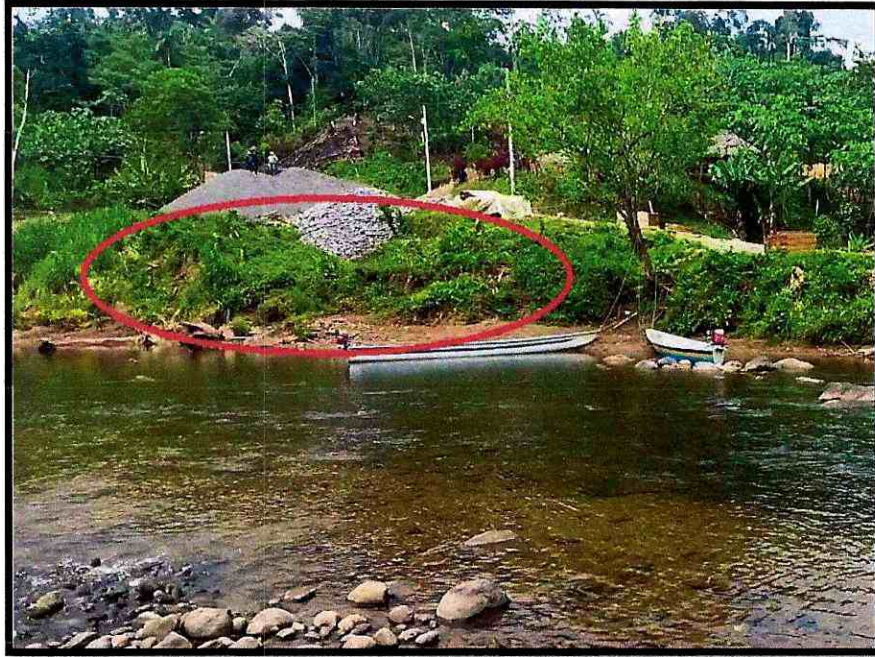
Ilustración 1. socavación existente en zona de implantación del puente
