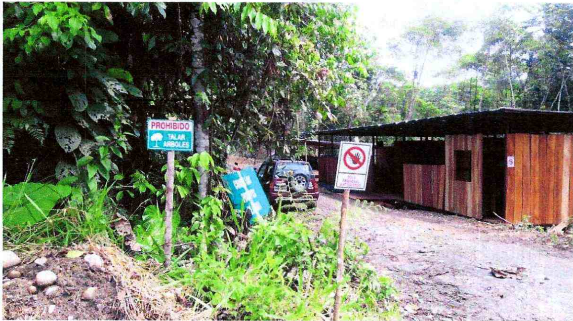
IMAGEN 1. CAMPAMENTO DEL PROYECTO EN CONSTRUCCIÓN
