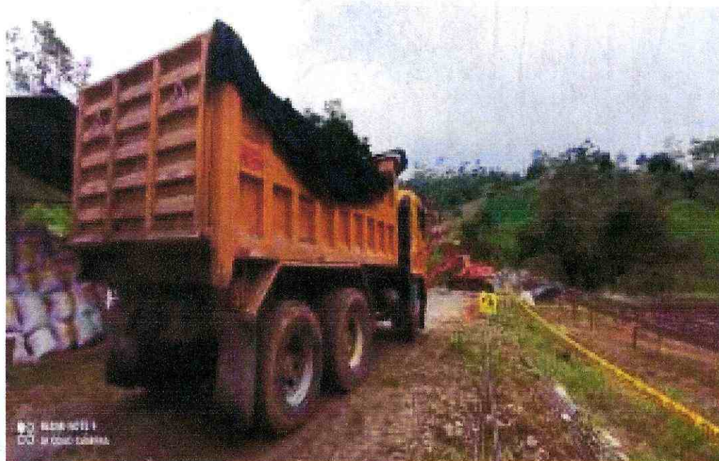
Imagen 1. Lonas cobertoras en las volquetas
