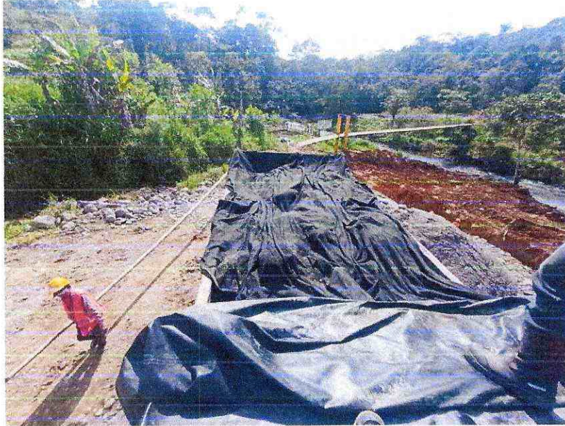
Anexo 4.- Lona cobertora sobre la volqueta para evitar la propagación de material particulado
