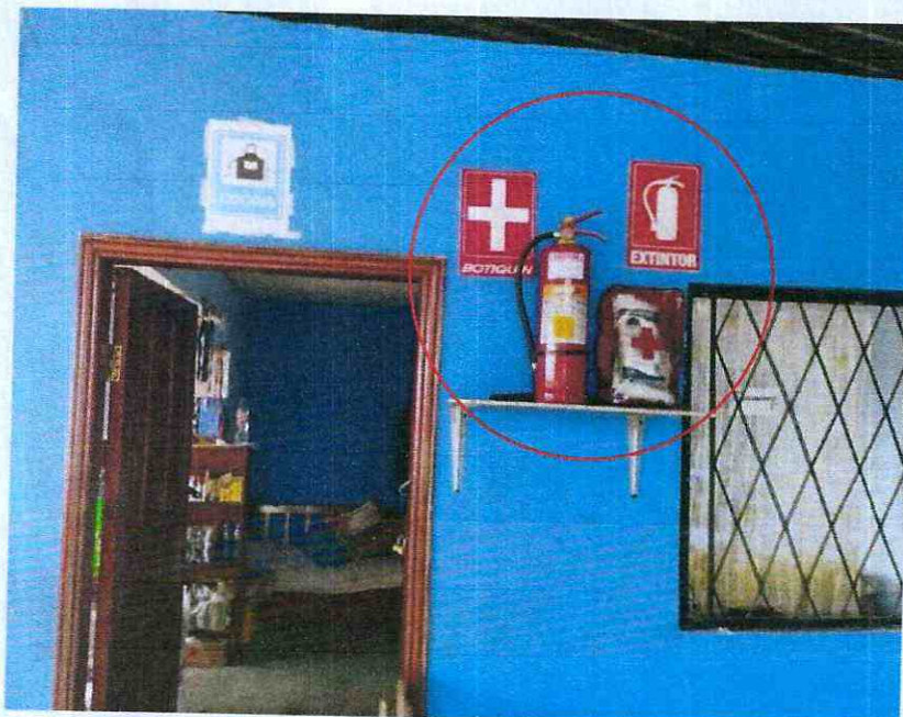
Anexo 7.- Extintor y botiquín al alcance de los trabajadores
