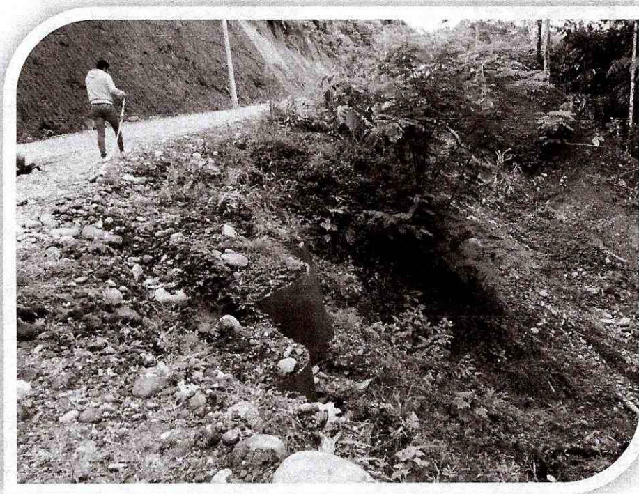
ZONA DE DESLIZAMIENTO
