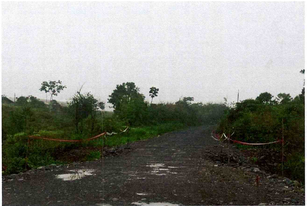
Zonificación de áreas intervenidas con cinta de peligro.
