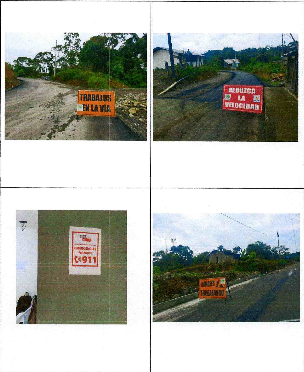
Señalética preventiva e informativa ubicado a lo largo y ancho del proyecto, etapa de construcción 2022 y 2023.
