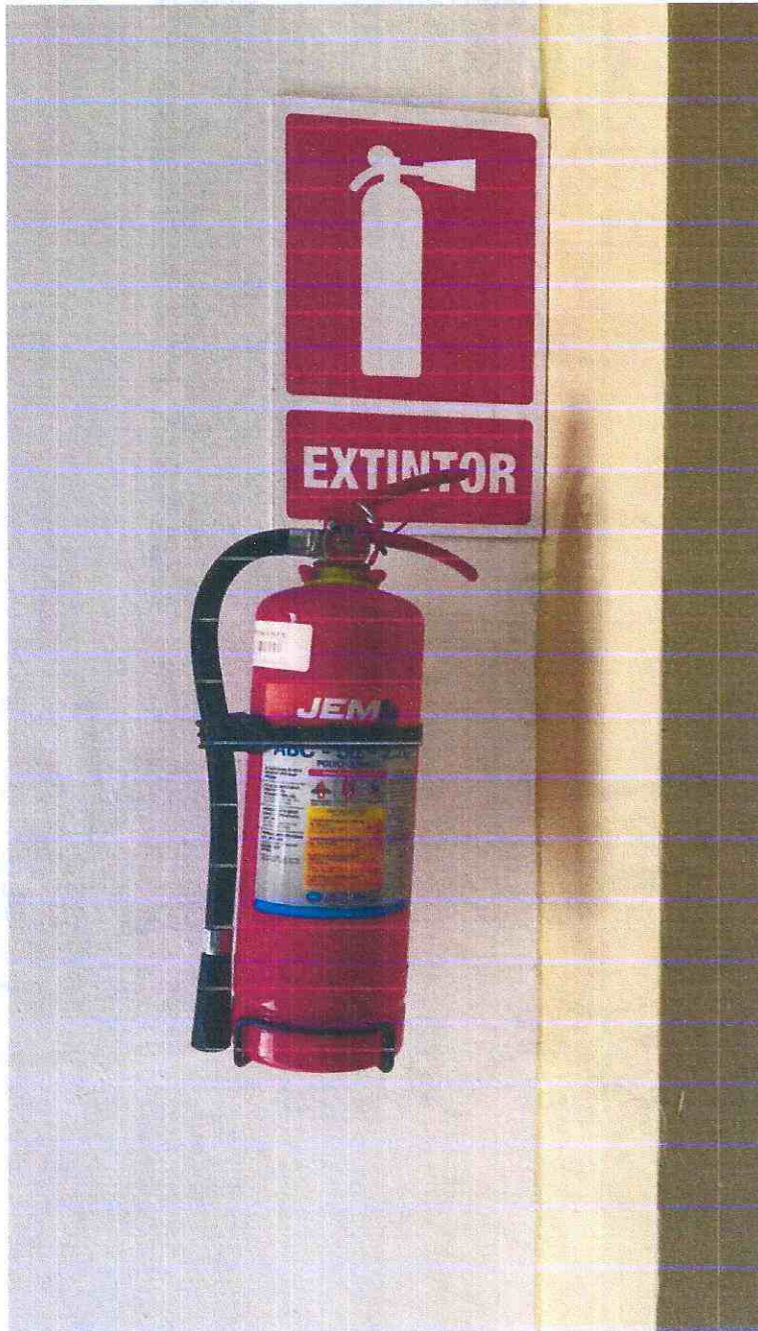
VERIFICACION SEÑALETICA Y EXTINTOR
