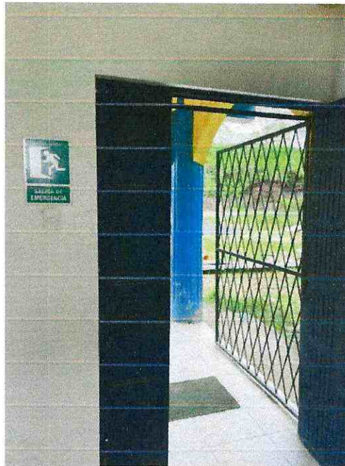
SEÑALETICA DE SALIDA DE EMERGENCIA
