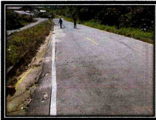
Ilustración 9.- HUNDIMIENTO DE ASFALTO POR FALLA GEOLOGICA
