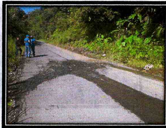
Ilustración 2.- FALLA CON PRESENCIA DE AGUA
