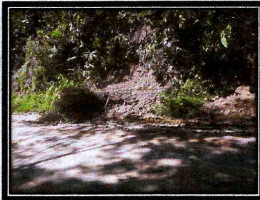
Ilustración 8.- DERRUMBES EN LA VIA
