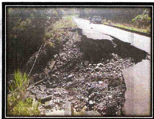
Ilustración 4.- FALLA DE LA ESTRUCTURA DE LA VIA
