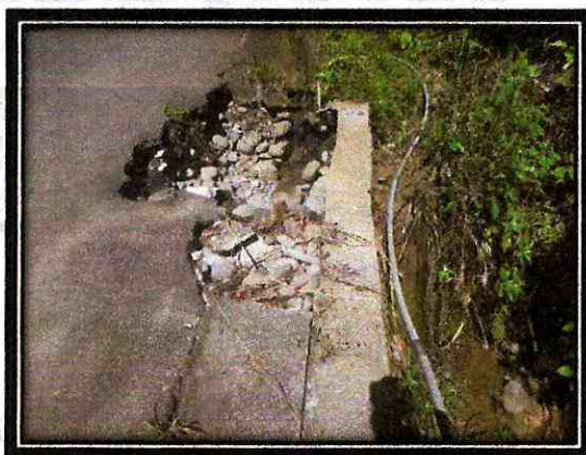
Ilustración 6.- SOCAVACION EN LA VIA POR FALTA DE CUNETAS
