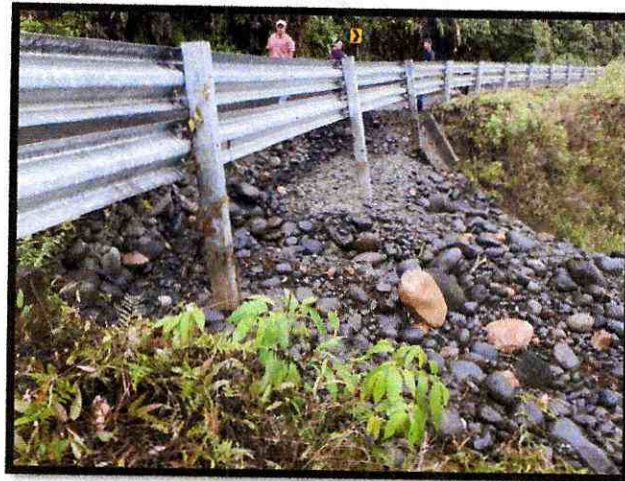
Ilustración 2 Perdida de cuneta
