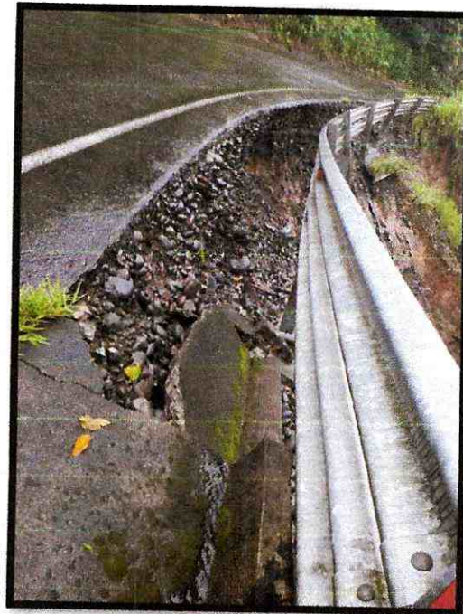
Ilustración 4 Material disgregado de la vía
