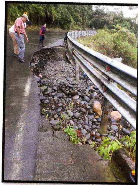
Ilustración 1 Socavación de la vía
