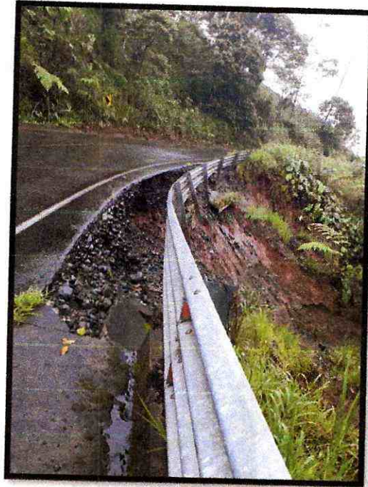
Ilustración 3 Guarda vía sin apoyos
