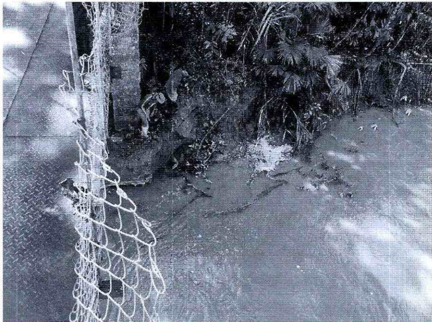
Ilustración 7, Socavación bajo la cimentación superficial del castillo
