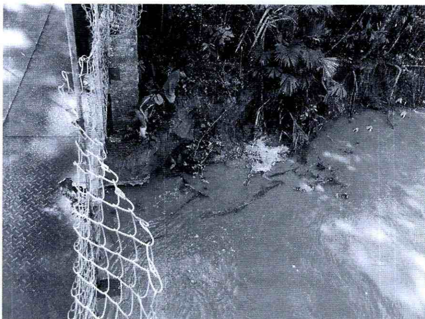
Ilustración 7, Socavación bajo la cimentación superficial del castillo
