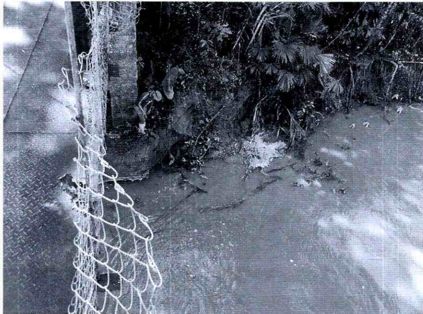
Ilustración 7, Socavación bajo la cimentación superficial del castillo
