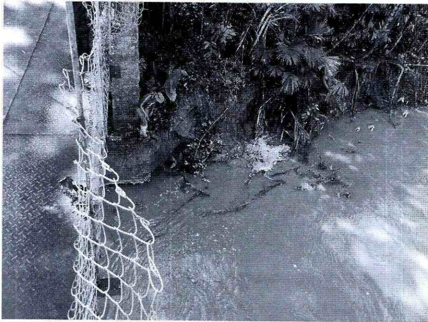
Ilustración 7, Socavación bajo la cimentación superficial del castillo
