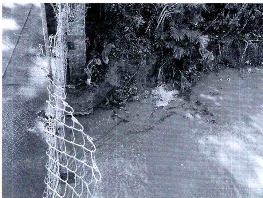
Ilustración 7, Socavación bajo la cimentación superficial del castillo
