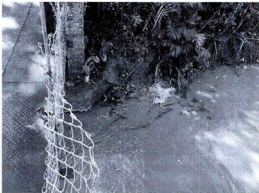
Ilustración 7, Socavación bajo la cimentación superficial del castillo
